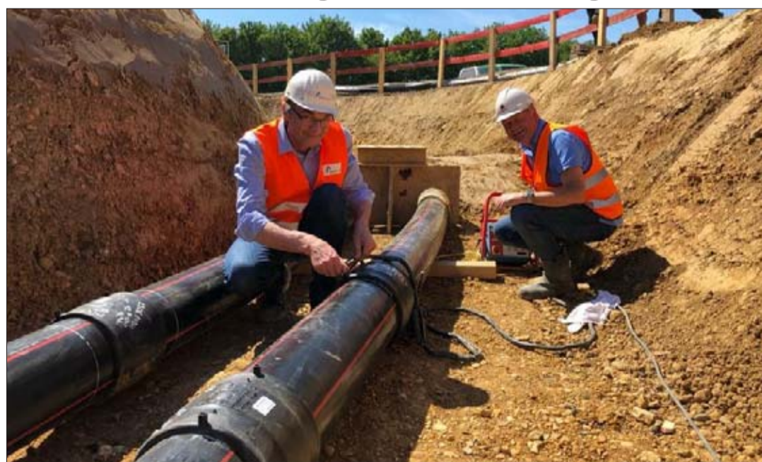
Rainer Millinghaus, Leiter Kabeltiefbau bei Amprion und Theo Heitkamp von der ARGE Amprion Alegro Aachen, beim Schweißen der letzten Muffenverbindung der Kabelschutzrohranlage.
